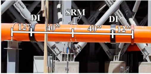
Improperly spaced DI and RS
